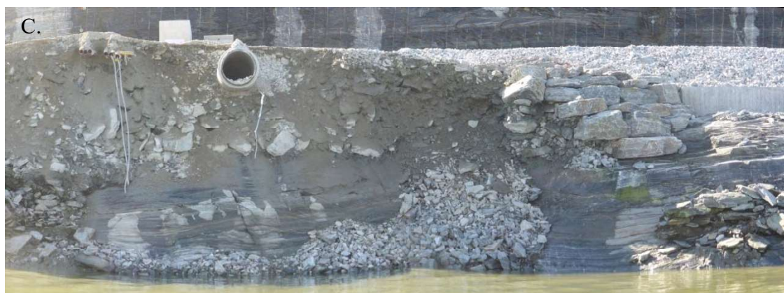
Fig. 7. A. Område A på raskanten som grenser til veien der molo før traff land. Gul sirkel angir område med høyest bevegelse. B. Nærbilde av påkjørte masser som hviler på finkornede masser. C. Område B og C på raskanten som grenser til vei rett nord for molo.
